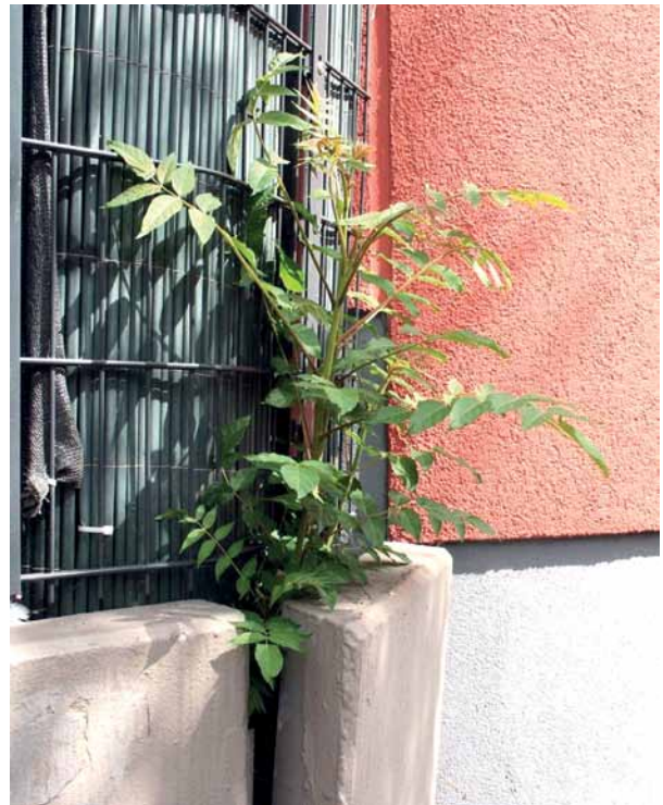
Ein Mauerspalt genügt. Foto: Elke Behrends
