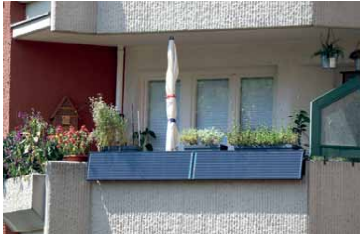
Ein private Balkonsolaranlage im Brunnenviertel in einem Haus des Wohnungsunternehmens degewo. Foto: Andrei Schnell
